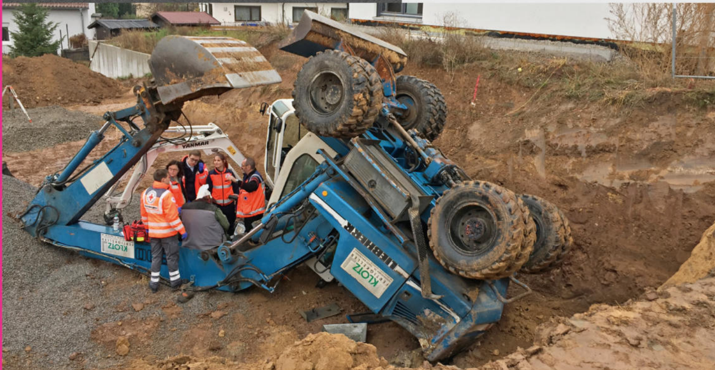
Bagger liegt kopfüber in einer Baugrube
